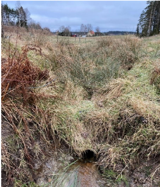
Figur 8. Norra diket som mynnar i ledning ca 200 m norr om plangräns i nordväst.
